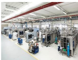
Foto 3: Produktion für die Pharmaindustrie im Werk in Riese Pio X (Foto: Steelco)
